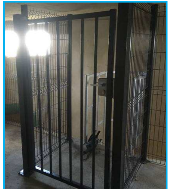
Double accès intérieur réservoir
