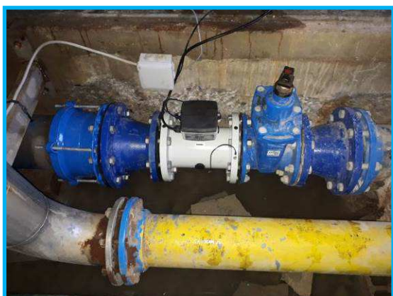
Beaulieu – Débitmètre DN150mm admission réservoir
