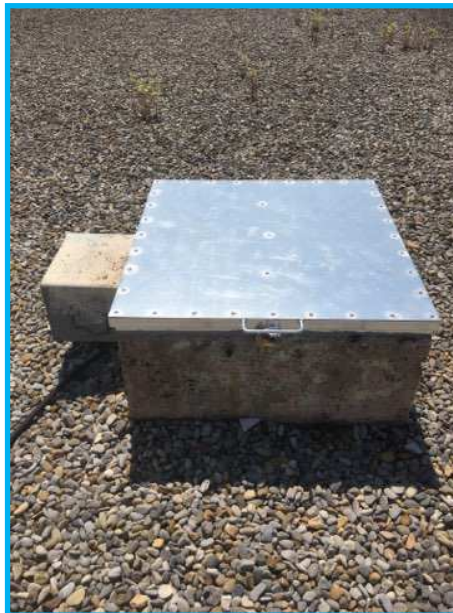
Trappe d'accès cuve réservoir
