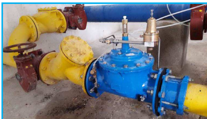
Clapiers – Vanne altimétrique DN250mm remplissage réservoir
